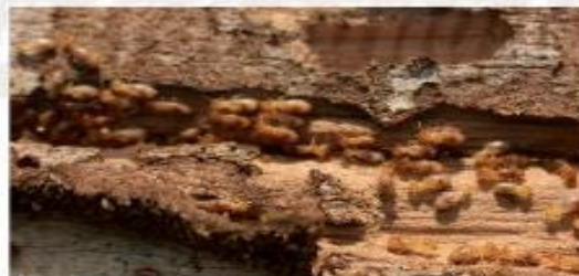
Mối phá hoại công trình xây dựng
